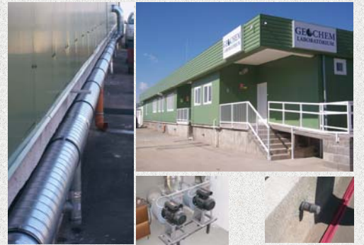
Az épület alatt kialakított csőrendszer kivezetései és a két ventilátor
